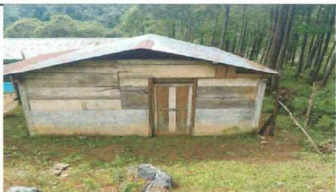
Foto 3: Puerta de madera deteriorada
