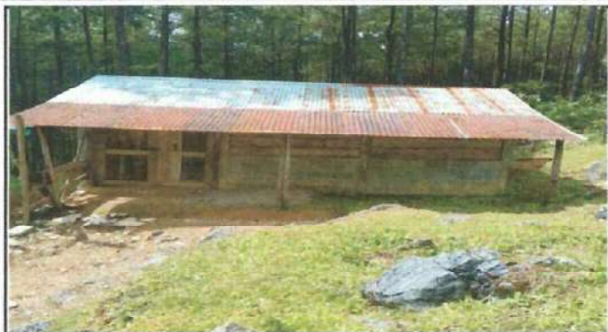
Foto1: Panorámica de cocina con techo deteriorado.
