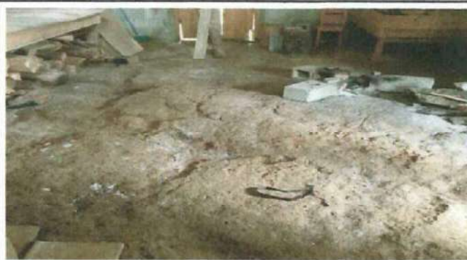
Foto 4: Piso en mal estado
