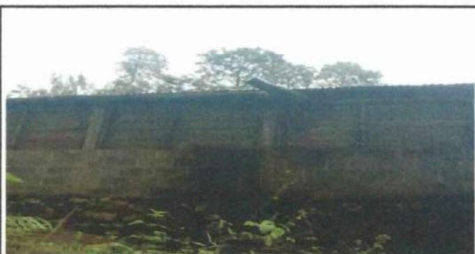
Foto 5: Paredes lado posterior con deterioro por humedad.
