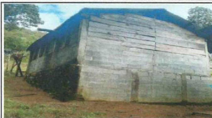
Foto 2: Parte posterior del Modulo II paredes con humedad por la lluvia.
